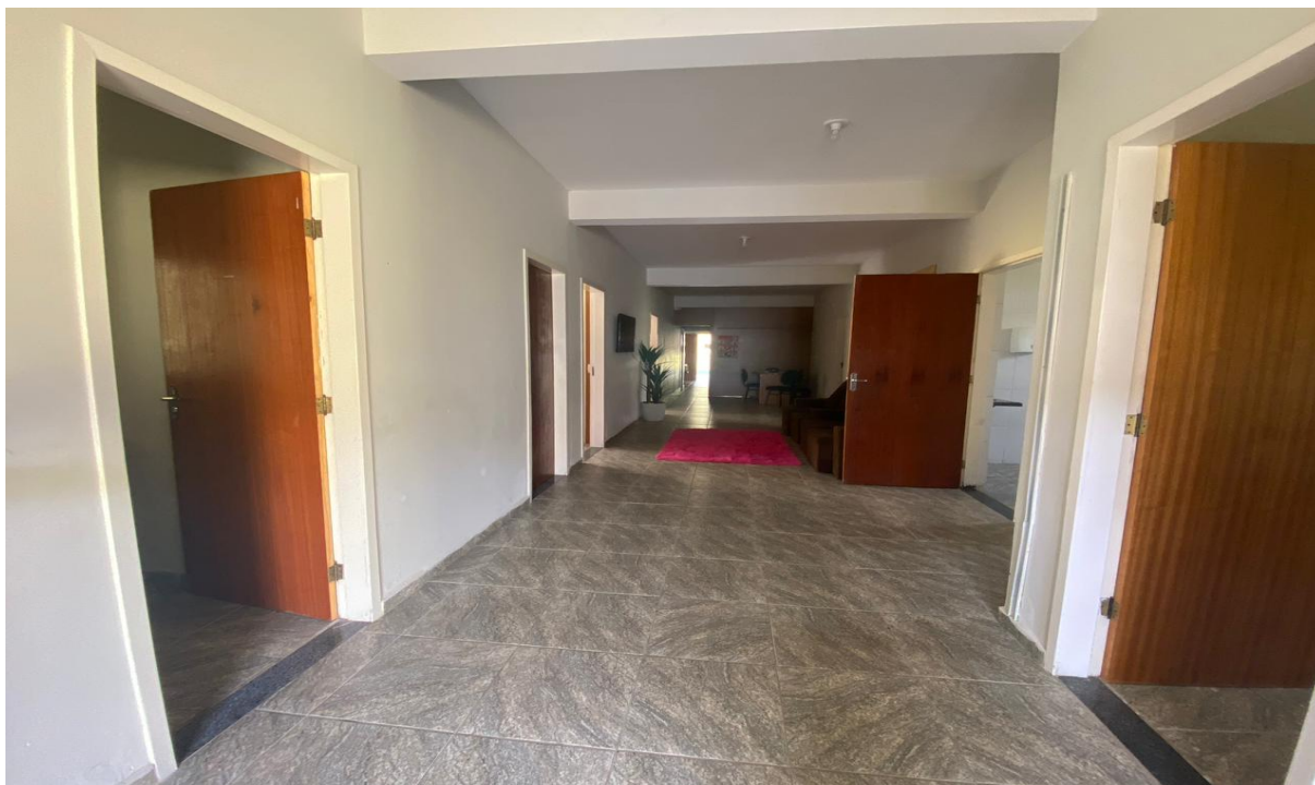
Figura 04: Piso danificado, desgastado e portas sem emassamento e pintura.
