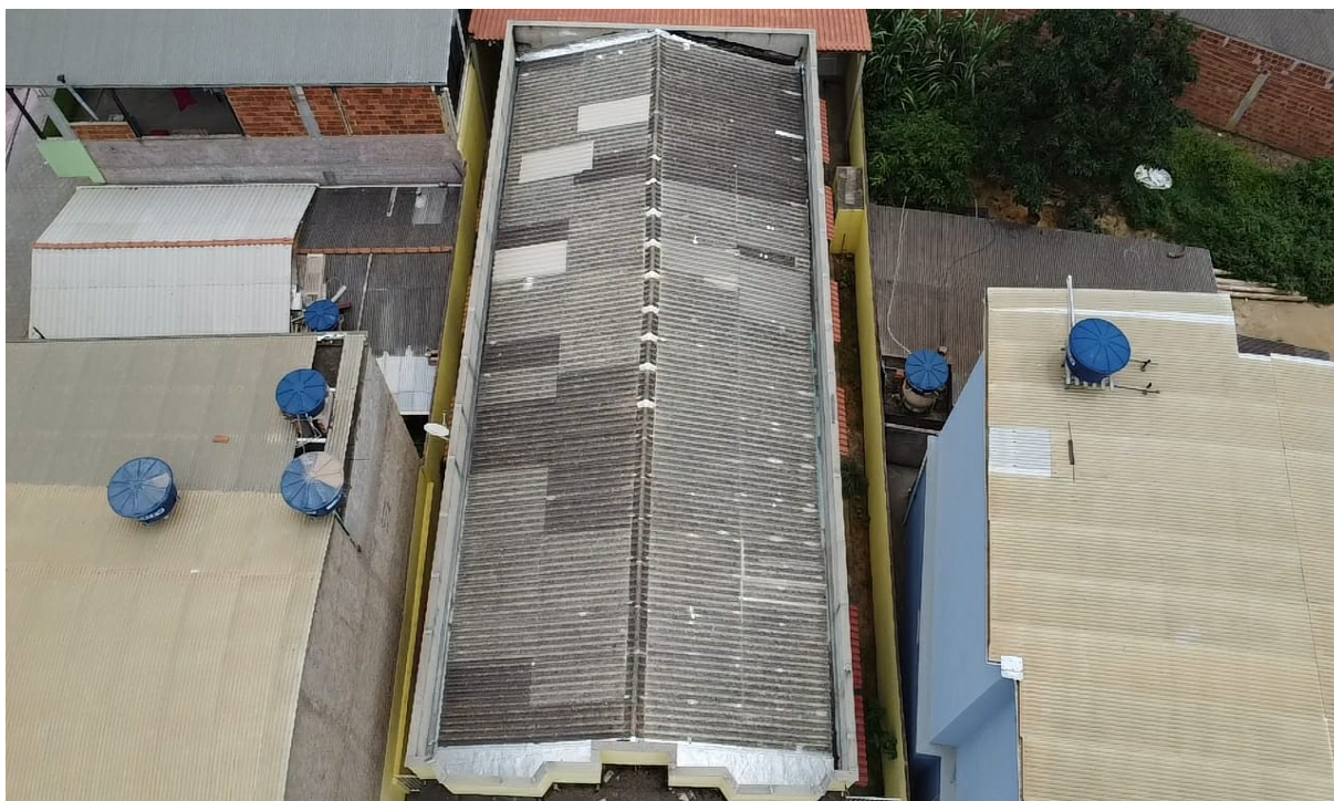
Figura 02: Telhado danificado, com vazamentos, gerando infiltrações.
