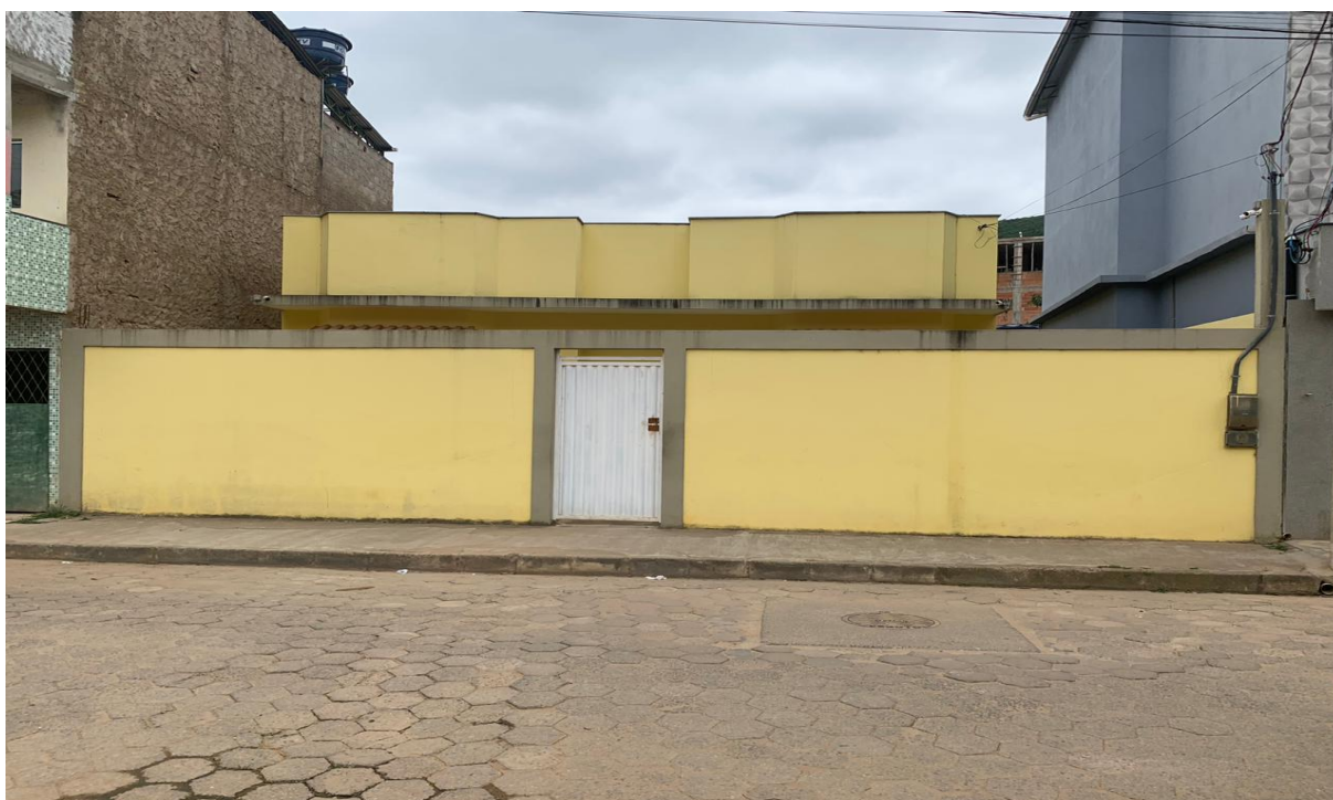
Figura 01: Pintura degradada, com mofos.
