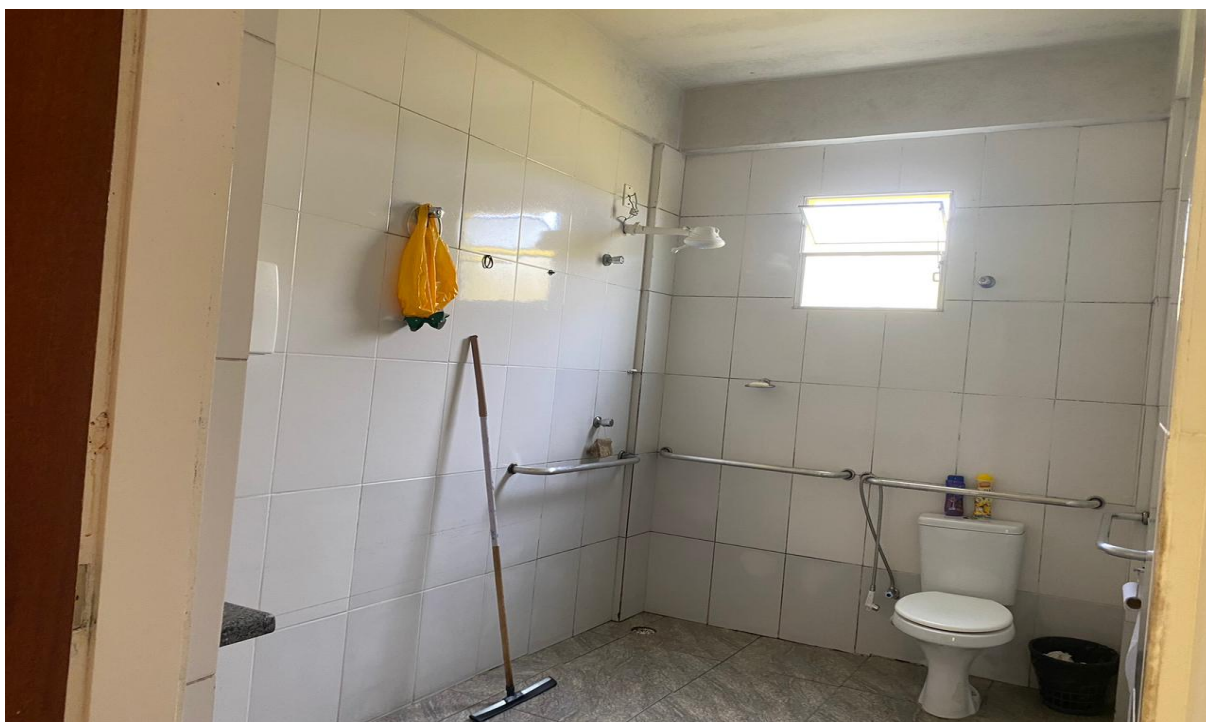
Figura 03: Infiltração nas paredes com azulejos e teto, cerâmica arranhada e danificada.
