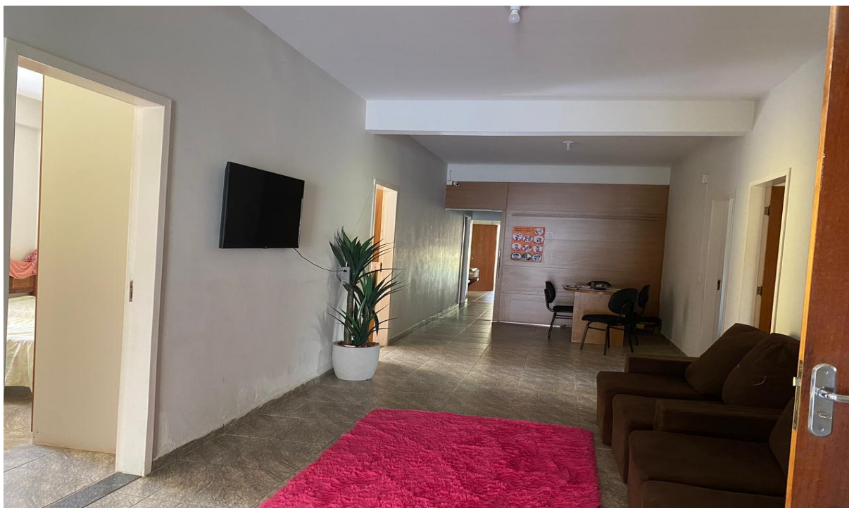
Figura 05: Parede com infiltração.
