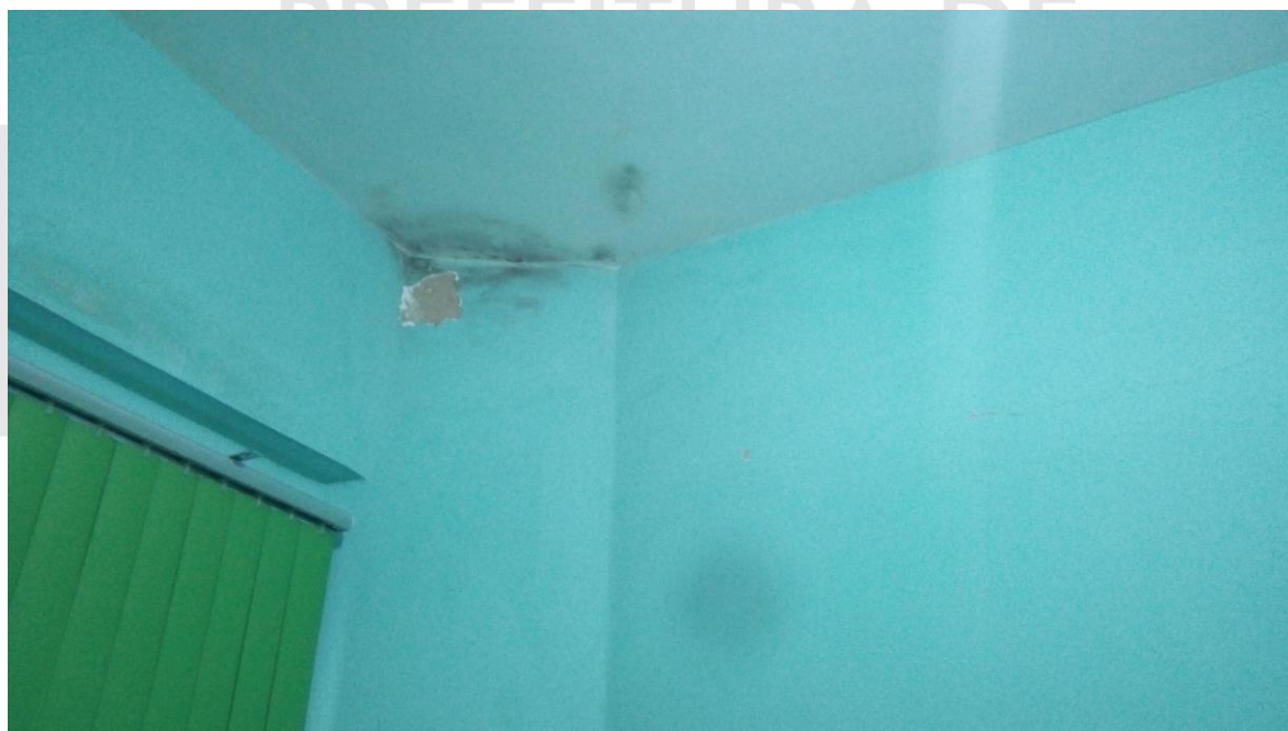
Figura 13. Infiltração em paredes e pintura descascada.
