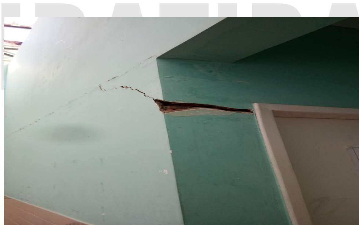
Figura 15. Trincas e fissuras em paredes.
