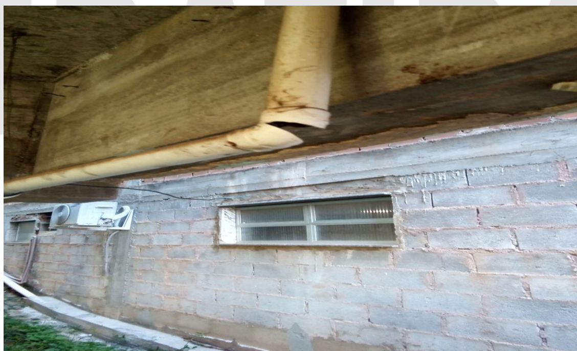
Figura 19. Problema de Instalações Hidráulicas.
