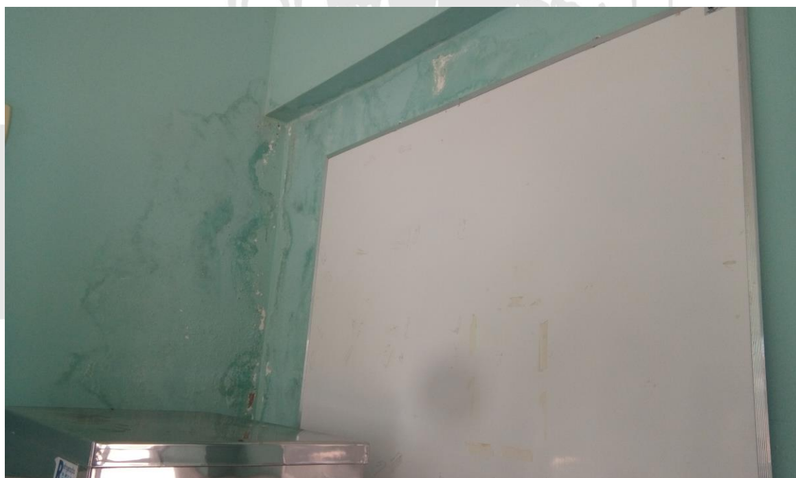
Figura 1. Infiltração em paredes.
