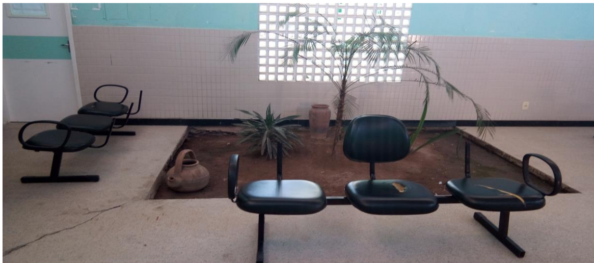
Figura 6. Fissura em piso granilite, ocorrido por conta de recalque – Hall de Atendimento
