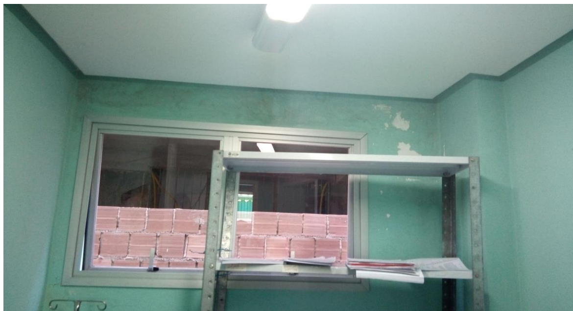
Figura 14. Infiltração em paredes e pintura descascada.
