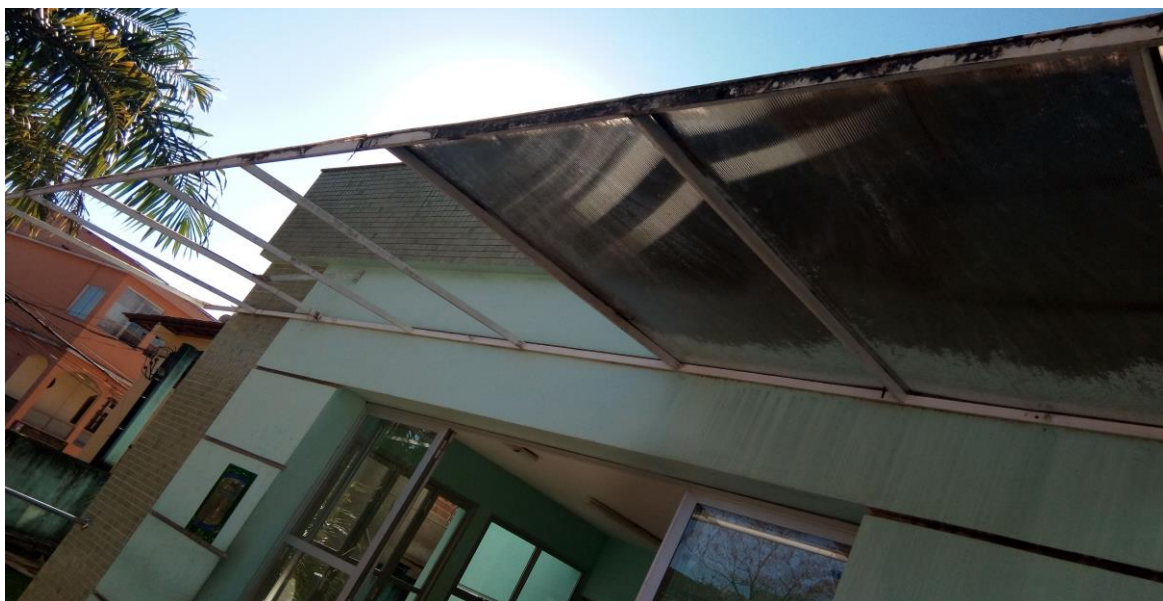
Figura 16. Cobertura destruída – Entrada do NESF.
