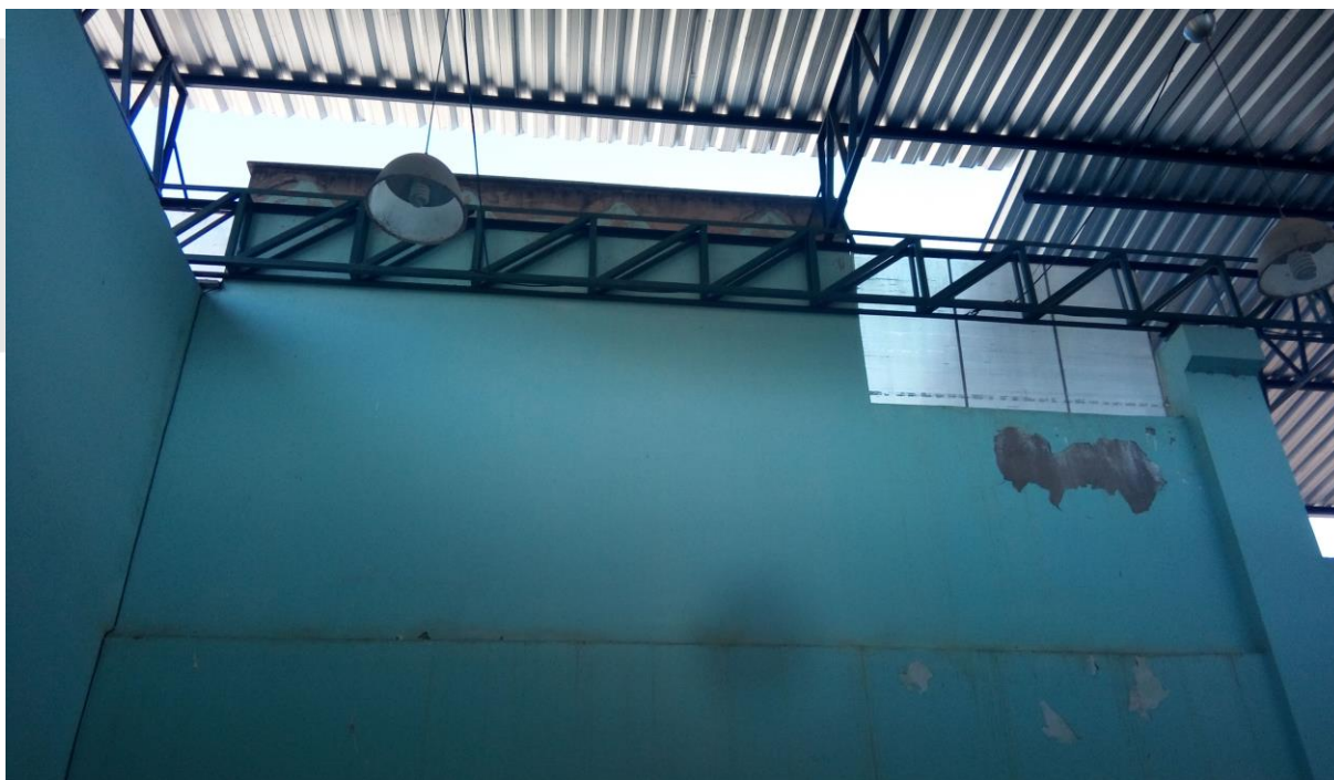
Figura 3. Necessidade de fechamento das laterais no hall de atendimento, pois ocorre entrada de águas pluviais e de pássaros.
