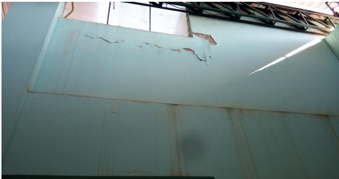
Figura 8. Bolhas e descascados em paredes.
