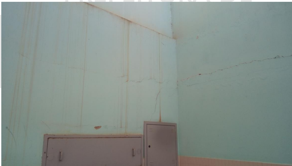
Figura 9. Fissuras em paredes.
