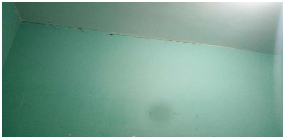
Figura 12. Trincas em paredes ocorridas por possível recalque de fundações.
