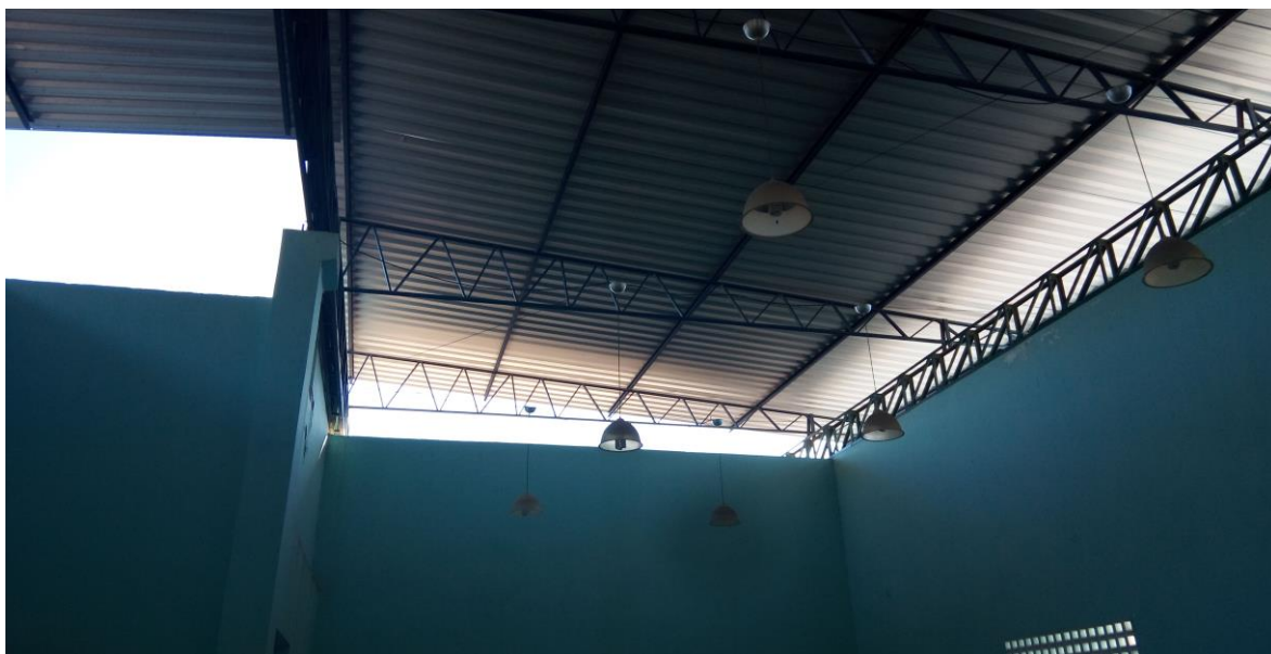
Figura 4. Necessidade de fechamento das laterais no hall de atendimento, pois ocorre entrada e águas pluviais e de pássaros.
