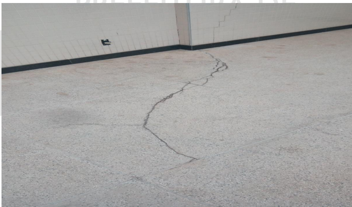
Figura 7. Fissura em piso granilite, ocorrido por conta de recalque – Hall de atendimento.
