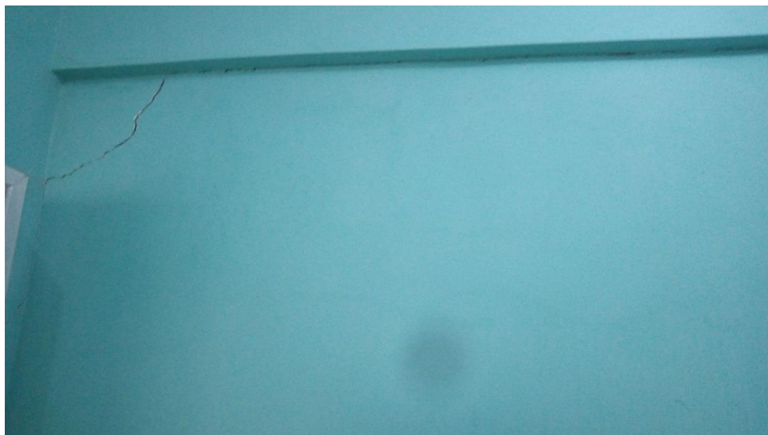
Figura 10. Trincas e fissuras em paredes.
