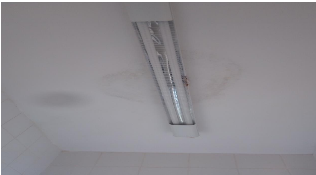
Figura 2. Infiltração no teto.
