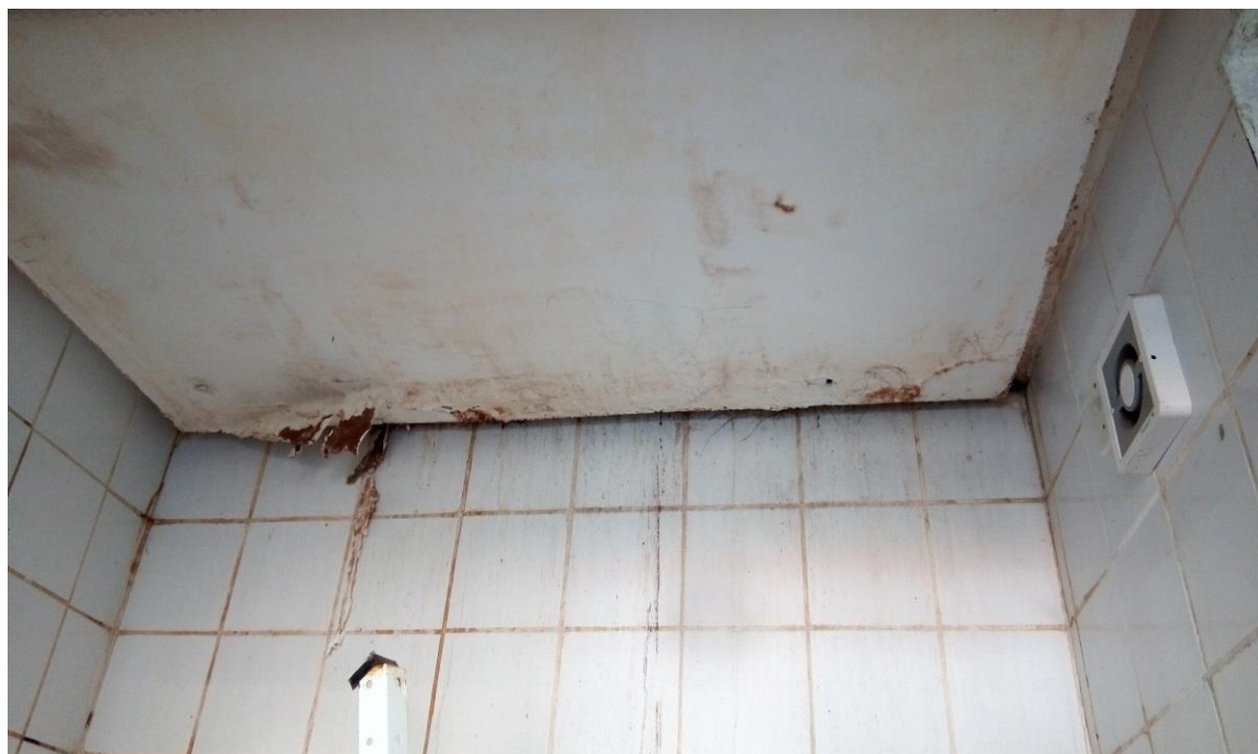
Figura 18. Infiltração em teto revestido em gesso.
