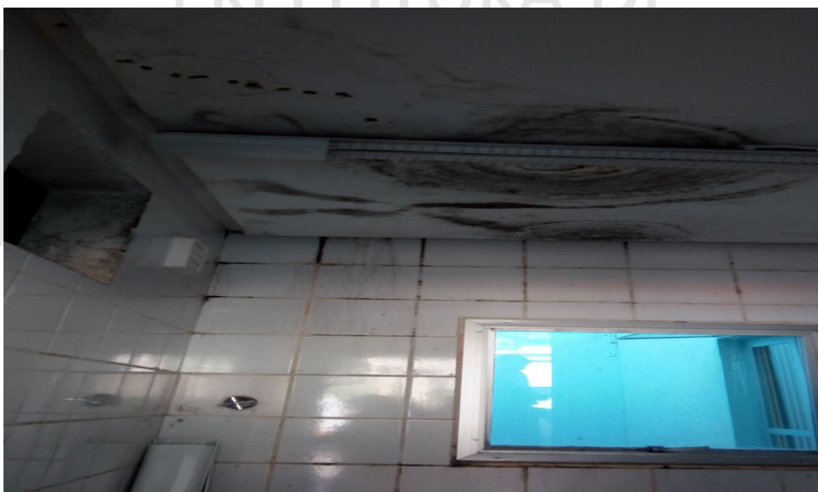
Figura 17. Infiltração em teto revestido em gesso.
