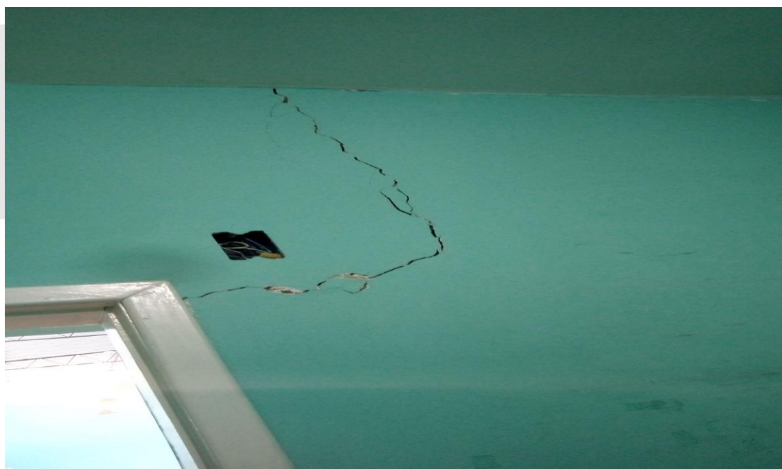
Figura 11. Trincas em paredes.
