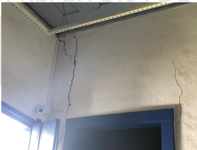
Foto – 02: Rachaduras na edificação do museu do tropeiro
