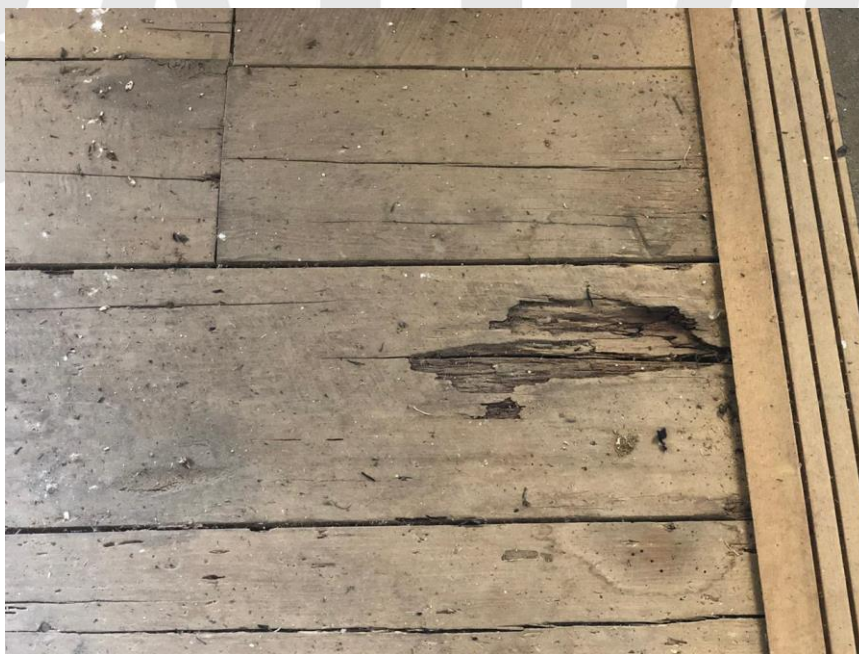
Foto10 – Assoalho com deterioração. (Acervo próprio).
