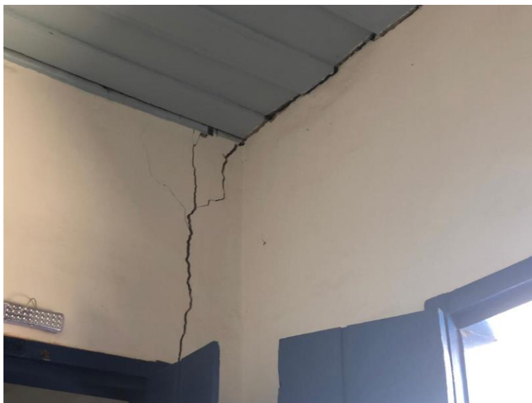
Foto – 01: Rachaduras na edificação do museu do tropeiro
