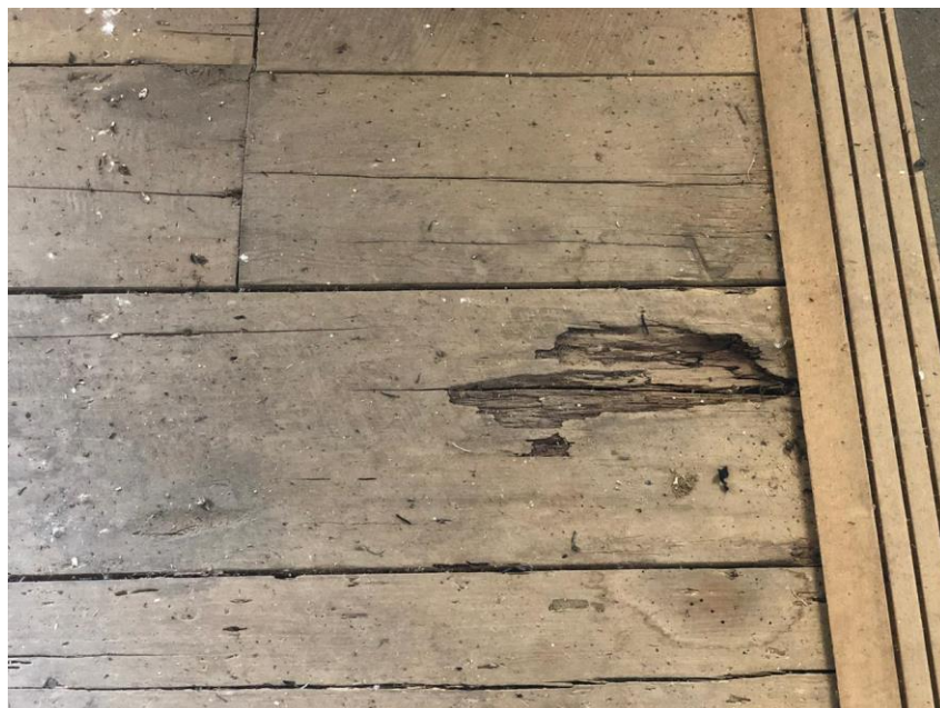
Foto – 03: Assoalho danificado.
