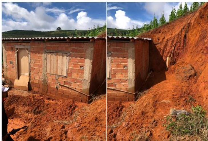
Figura 12: Registro de Deslizamento em Ibatiba -2022.
